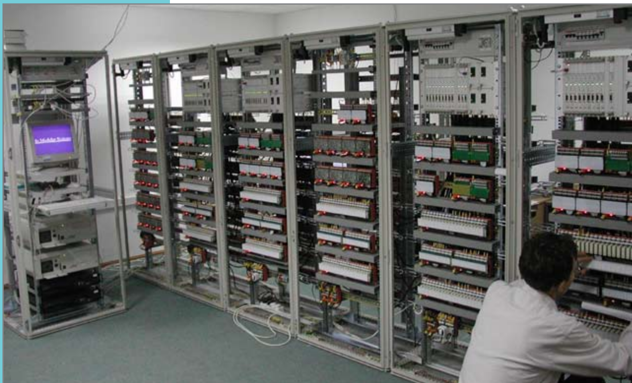
ПТК «Торнадо» на базе InTouch. Сборка на монтажном участке «Модульные Системы Торнадо»
