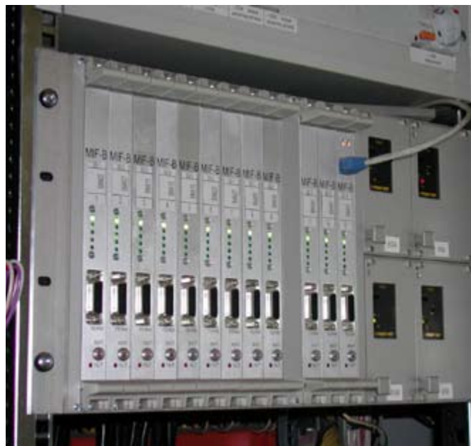
Шкаф MIF-контроллеров в ПТК «Торнадо»
